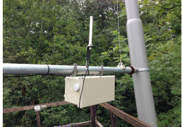
Gut geschützte Elektronikeinheit mit Rundstabantenne
